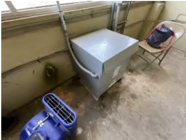
27. Step Down Transformer
