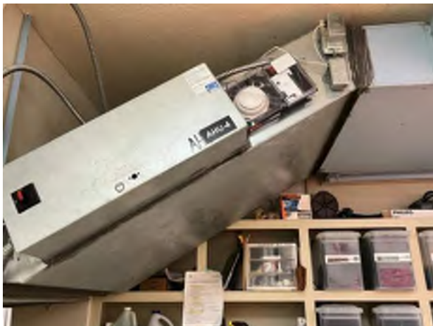
23. Air handling unit
