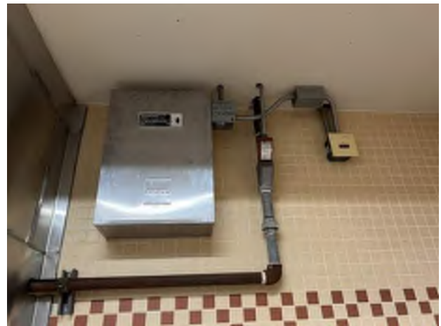
28. Ansul fire suppression system.
