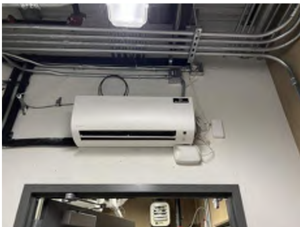
53. Electrical room fan unit.
