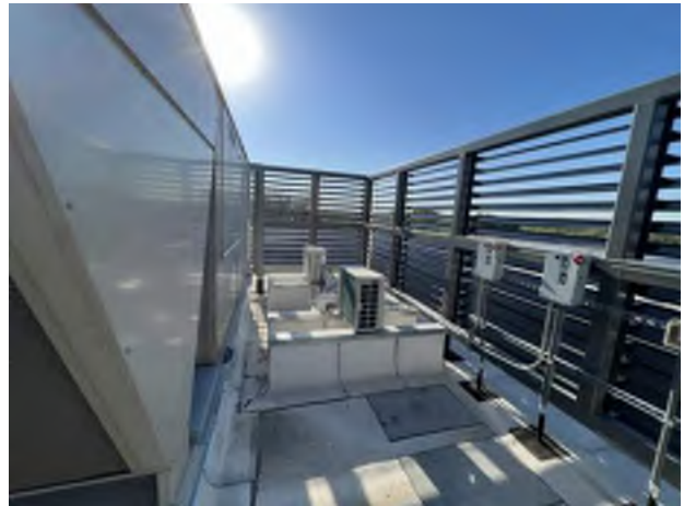
52. Mini split system condenser units.
