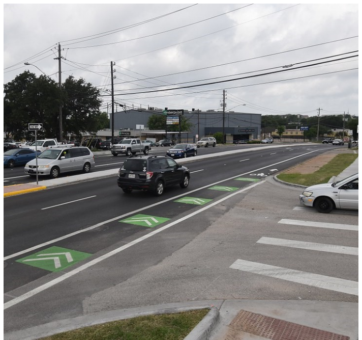
Se instaló una nueva división de concreto como parte del proyecto de seguridad en la intersección de IH-35 y Braker Ln (2019) para reducir el conflicto entre los vehículos que entran y salen de las entradas de acceso.
